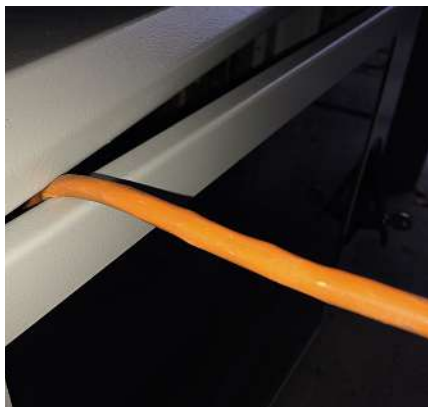
Bild 2: Ein eingeklemmtes Kabel in einer Schranktüre führt zu Störungen
